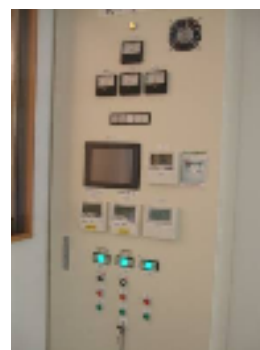
総合エネルギー制御監視盤
