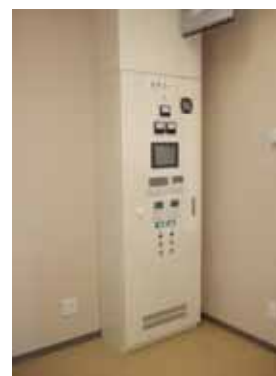
総合エネルギー制御監視盤
